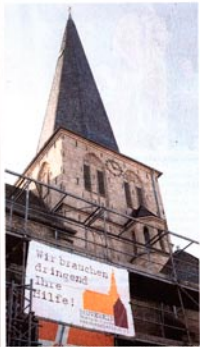
Seit zwei Jahren eingestürzt: Die Citykirche am Alten Markt muss grundlegend saniert werden.
